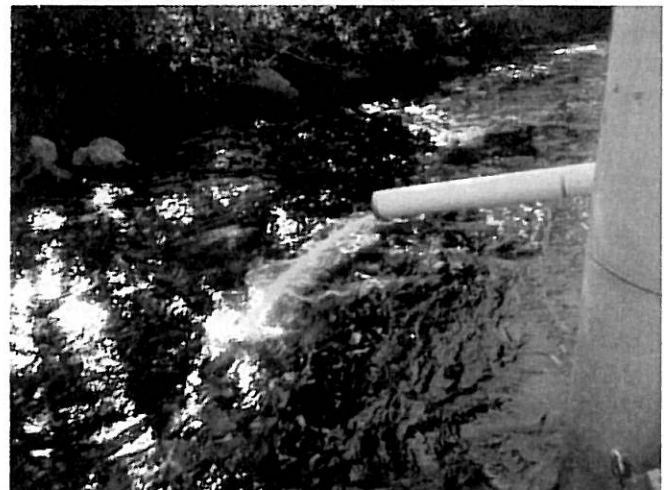
Kuva 24. Kalkin syöttöputki. Kalkki johdetaan liuoksena putkea pitkin jokeen. Oikealla pumppu- ja mittakaivo.
