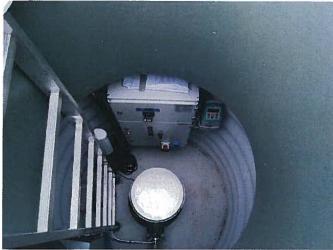
Kuva: Valmis kaivo sisältä, sähkökeskus ohjauslogiikka asennettuna
