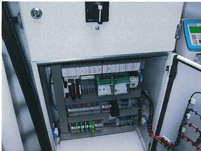
Kuva: Kaivon sähkö alakeskus ja ohjauslogiikka.
