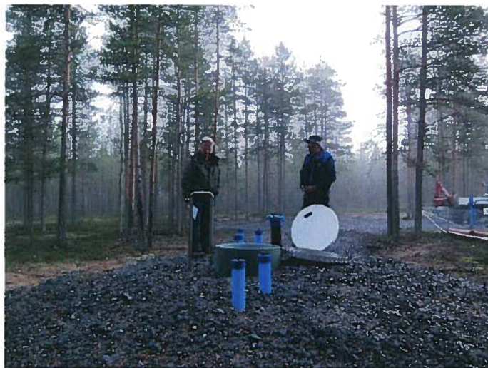
Kuva: Valmista kaivoa tarkastelemassa Aarne Miettunen, Pohjois-Pohjanmaan ELY keskus ja Hannu Kähkölä, Paavolan Vesi Oy
