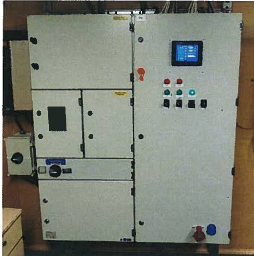
Kuva : Vartin vedenottamon sähkökeskus ja ohjauslogiikka
