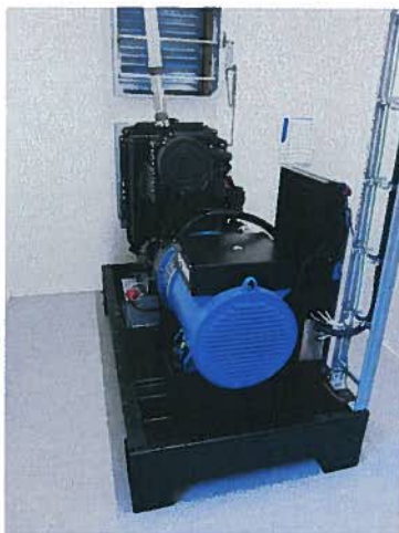
Kuva: Varavoimalaite suojarakennuksen sisällä.
