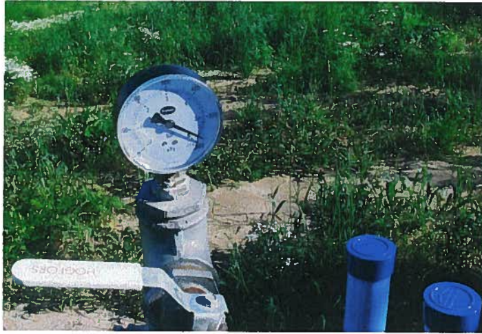
Kuva: Painetaso Karinkannassa uuden syöttöjohdon päässä n. 5,8 bar
